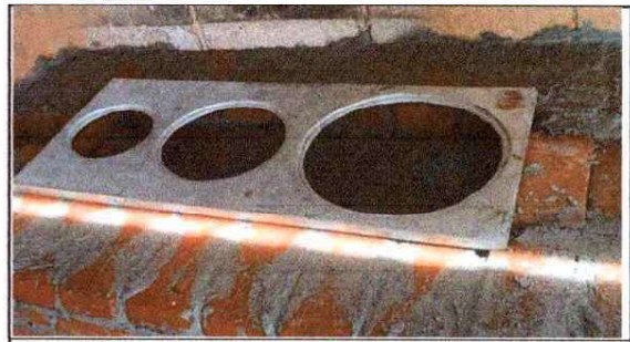
FOTO 12: Sustrución de plancha de metal de 3 hornillas
